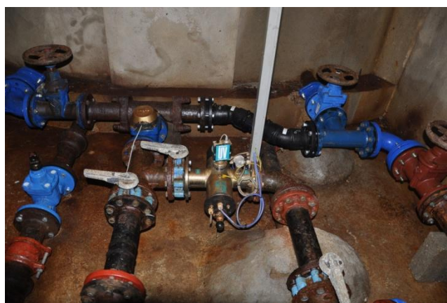
Vue de l'installation de jumelage, au centre l'ampoule de traitement U.V.
