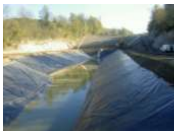
Bassin étanche des eaux de pluie
